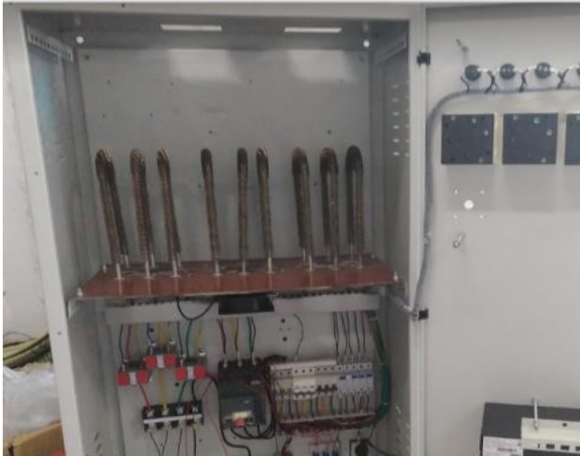
Рисунок 1 – Низковольтный распределительный шкаф
